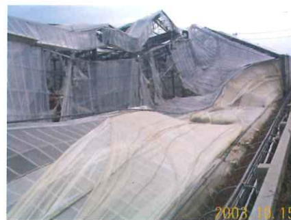
写真2 2003年台風14号来襲による園芸施設の被災状況
